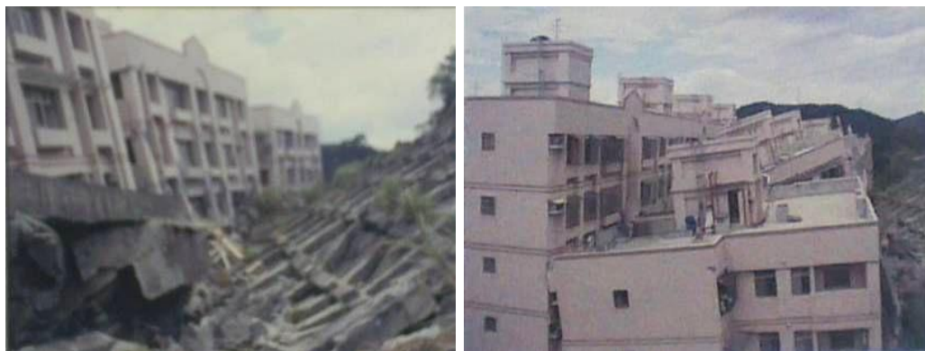
圖 2：民國 86 年 8 月溫妮颱風侵襲台灣，林肯大郡損壞情形。
